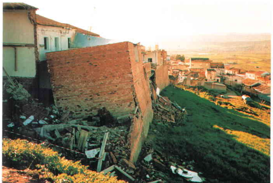
Desprendimiento de tierras en Santo Tomé (Jaén), en diciembre de 1996.
